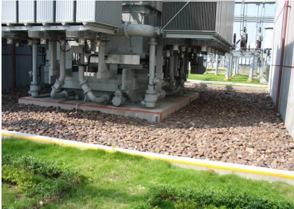
已建主变油坑
